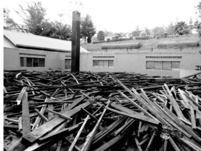
屋根がすっかり落ちてしまったホール。床に散らばる木材たち。しかし誰も怪我しないで良かった…。
