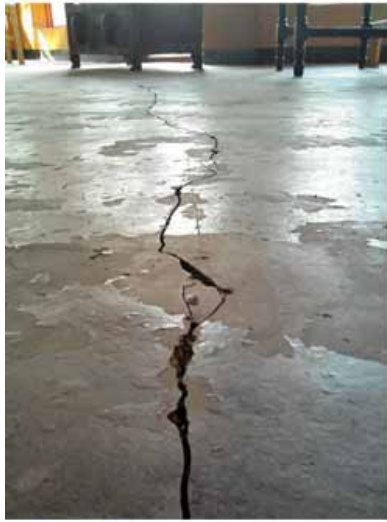
<亀裂が入ってしまった床>
